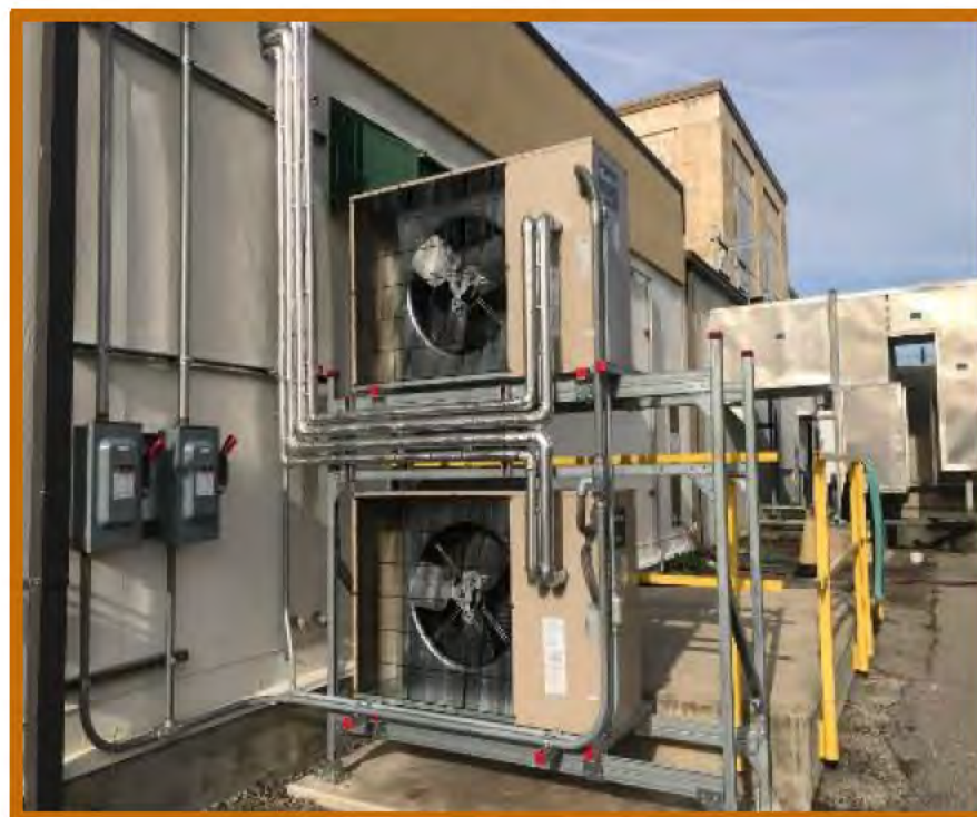
736-A New HVAC
