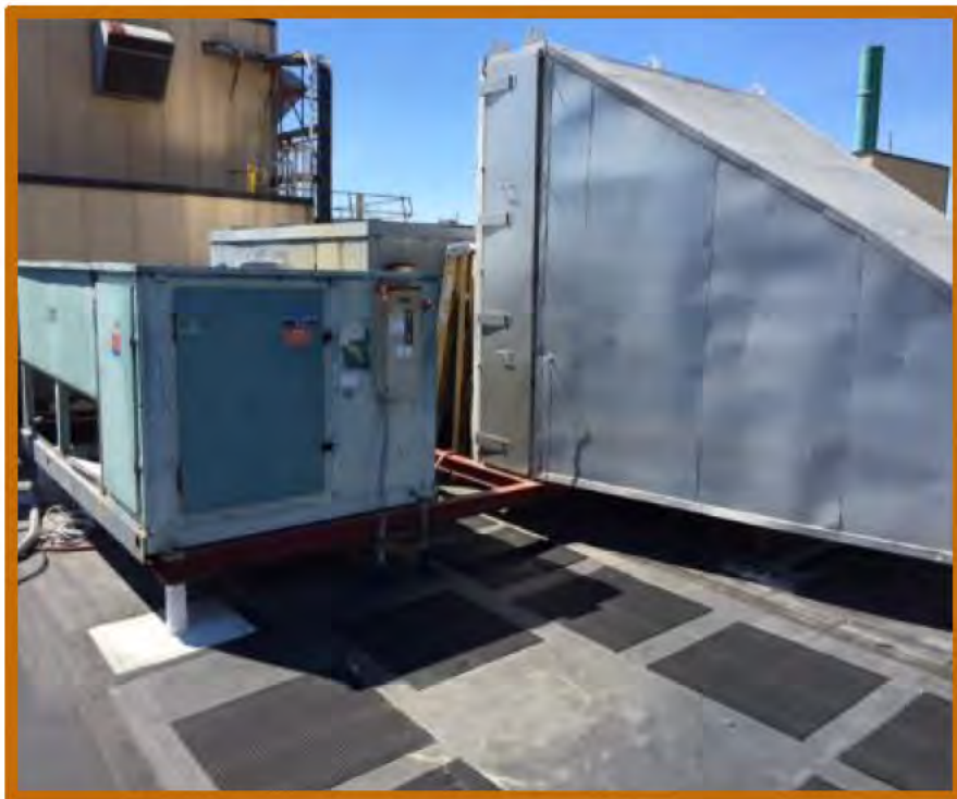
736-A Old HVAC
